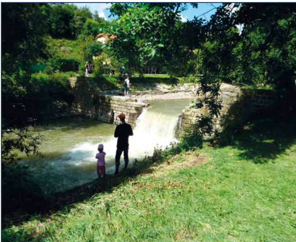
VVT Brumovka řkm 2,855 - poškozený stupeň
