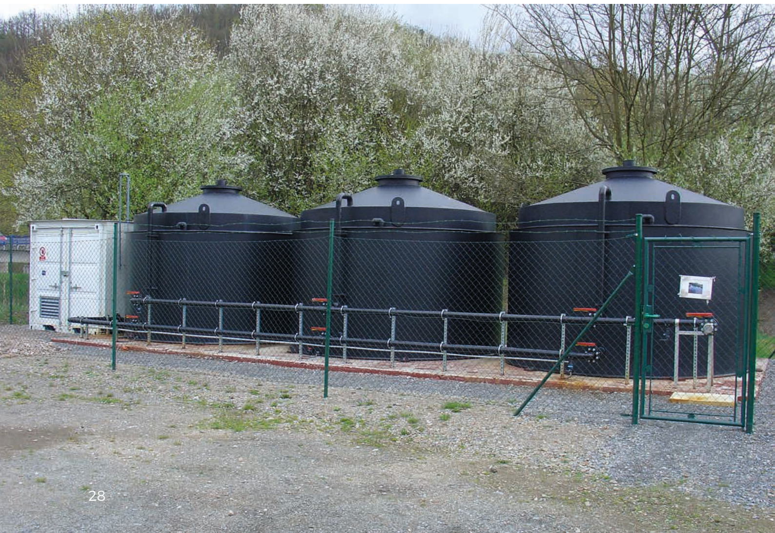
Zařízení pro dávkování síranu železitého na přítoku do nádrže ↓
